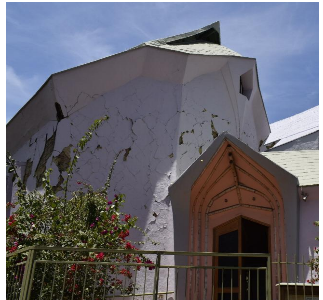
Die beschädigte Kirche in Cali. FOTO: Andreas Loos
